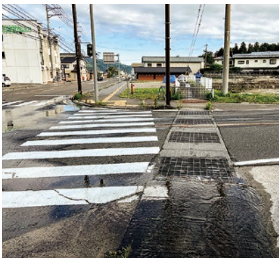
写真：大雨後の溢水の状況(俵町)
