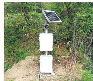
設置された監視システム
