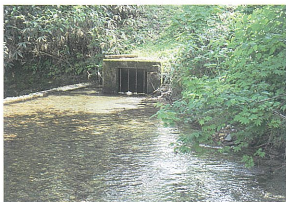
源汲堰の取入れ口
