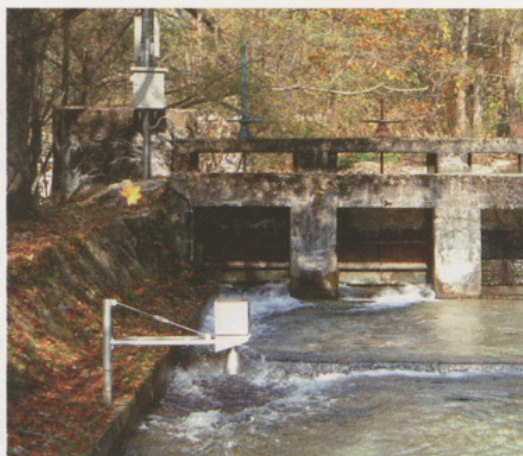
設置された水位監視装置
